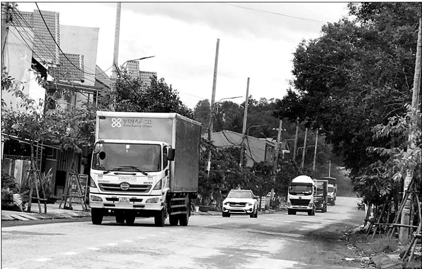
Tuyến đường ĐH2 xã Hòa Sơn có nhiều xe trọng tải lớn đi vào khiến đường xuống cấp, hư hỏng gây nguy hiểm cho người tham gia giao thông.
